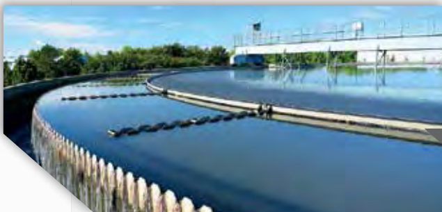
Очистные станции Water Treatment
