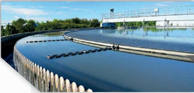
Su Arıtma Tesisi Water Treatment
